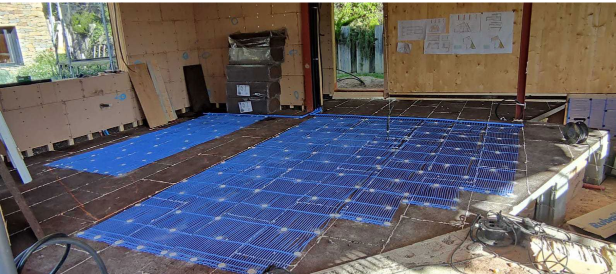
Fußbodenheizung und -kühlung im Estrich
