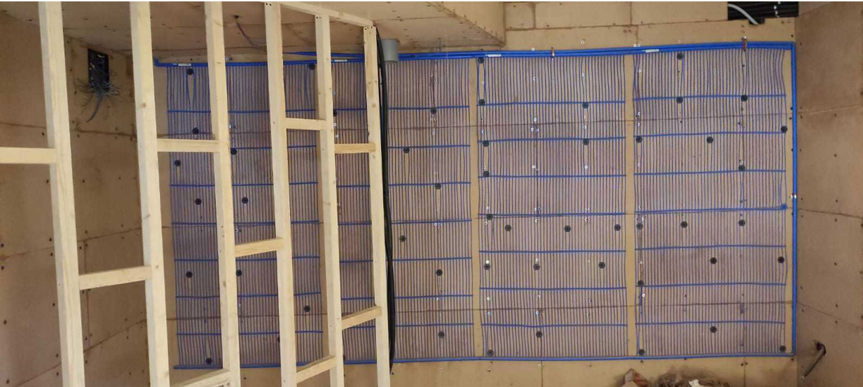
Wandheizung und -kühlung im Lehmputz
